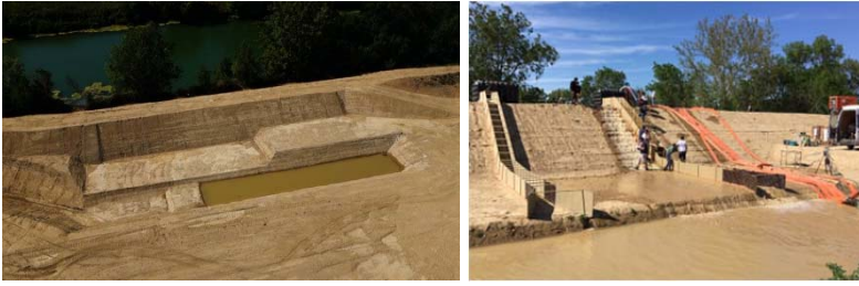
FIGURE 1 : VUE AERIENNE DE L'OUVRAGE DEMONSTRATEUR APRES REALISATION (GAUCHE) // ESSAIS DE SURVERSE IN SITU (DROITE)
