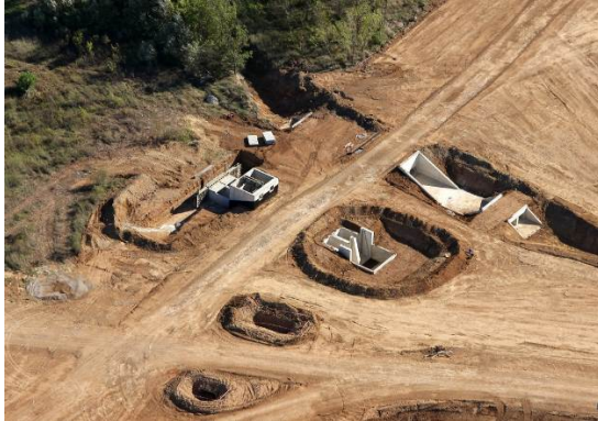
OUVRAGES DE GESTION HYDRAULIQUE TRAVERSANT ET DE POMPAGE AVANT ELEVATION DE LA DIGUE (©BRLi)
