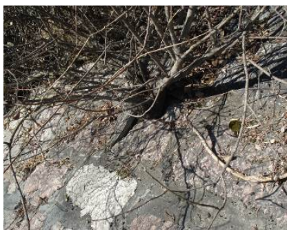
FIGURE 1 : DESTRUCTURATION EN COURS D'UN PERRE MAÇONNE PAR UN PEUPLIER AYANT ETE RECEPE PLUSIEURS FOIS.
